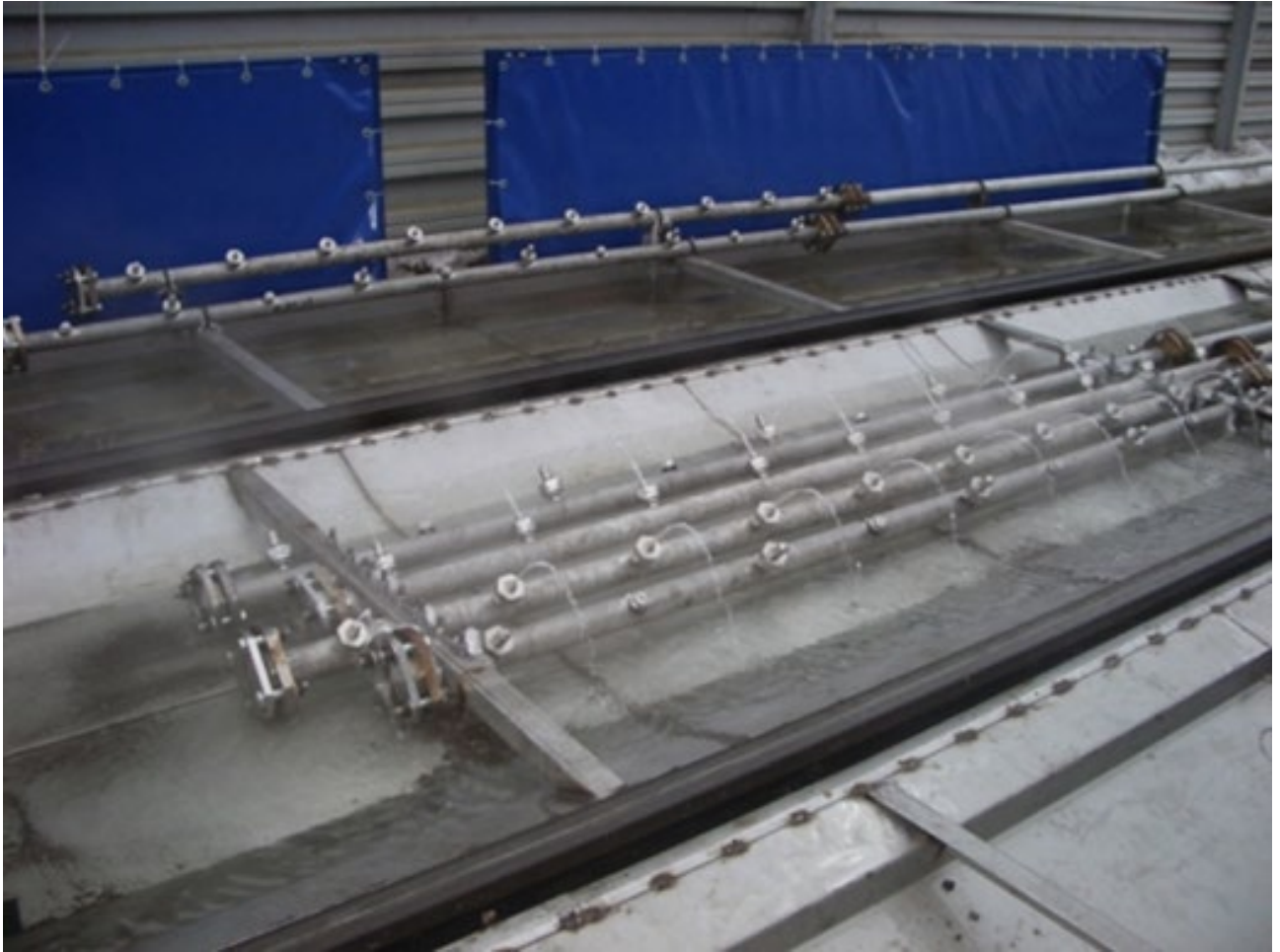
Figur 7-1 De-Icing anlegg på Alnabru. Foto: RailCombi, 2015
