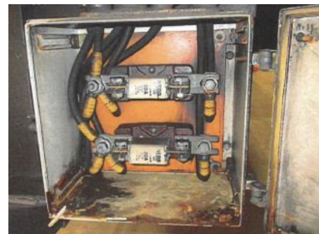
Figur 4 Sikringsboks som ble byttet i 2019
