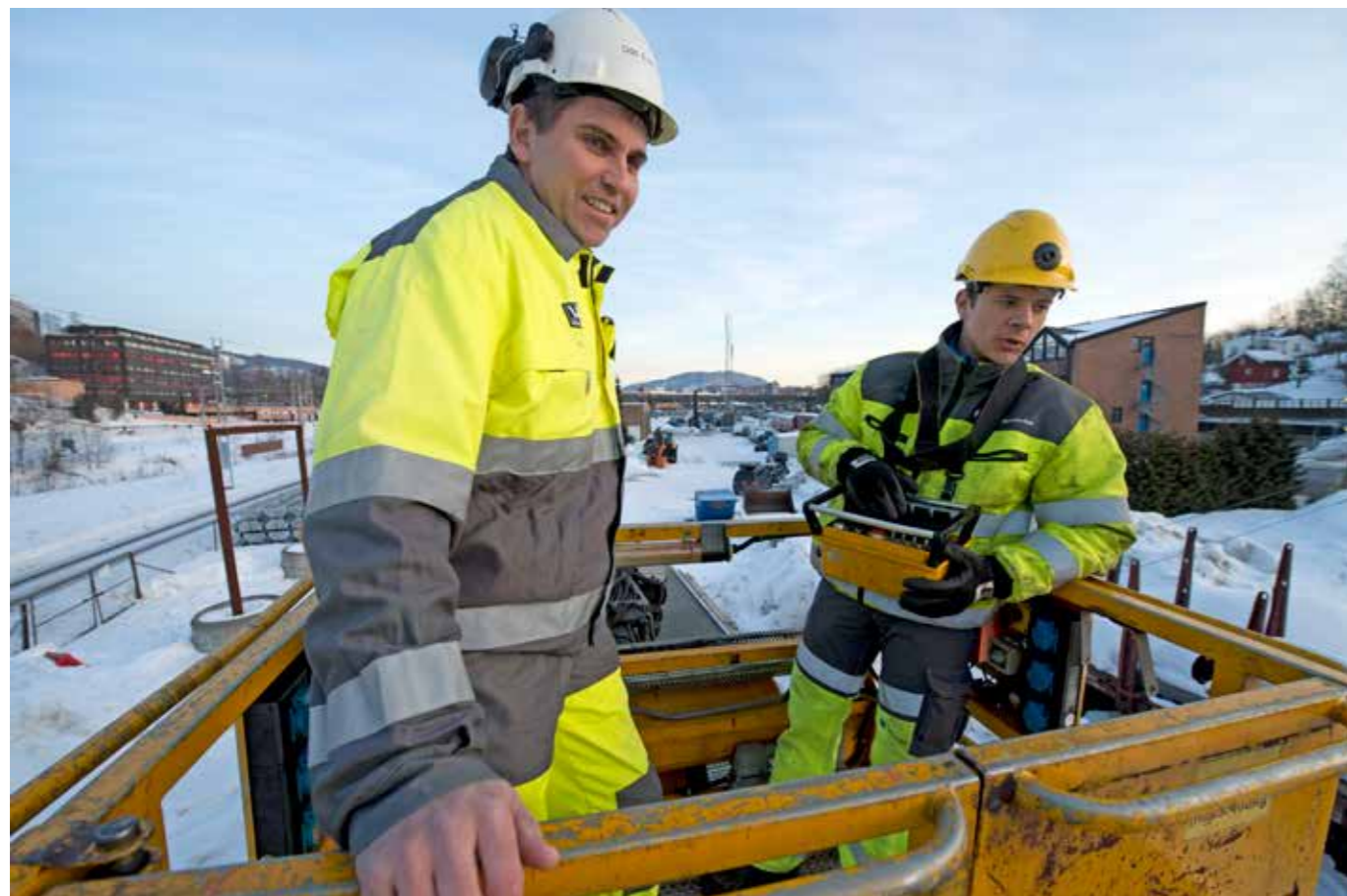
MÅ FORNYE: Vedlikeholdsdirektør Odd Erik Berg trenger forutsigbarhet til å holde to store KL-prosjekter gående samtidig. Her er han ute på jobb sammen med elektrotekniker Christian Bogar Kleven.
