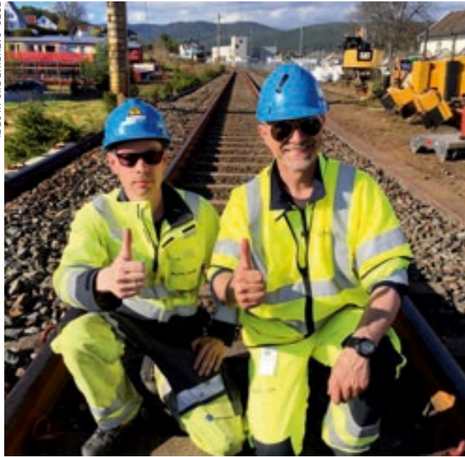
GODT FORNØYDE: Byggeleder Knut Hvila Solhaug (t.v.) og prosjektleder Lars Christen Kile i Bane NOR var ansvarlig for skinnedyttet sør for Kongsberg stasjon.
