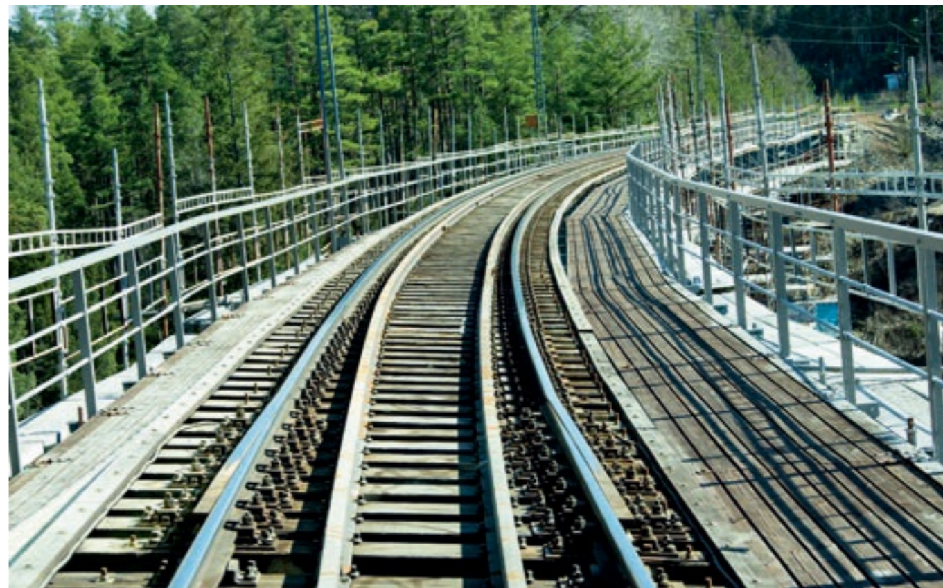
SVINGER SEG: Stål må bevege seg i takt med temperatursvingninger. Glideskjøt på Moripen viadukt. (Foto: Njål Svingheim)
