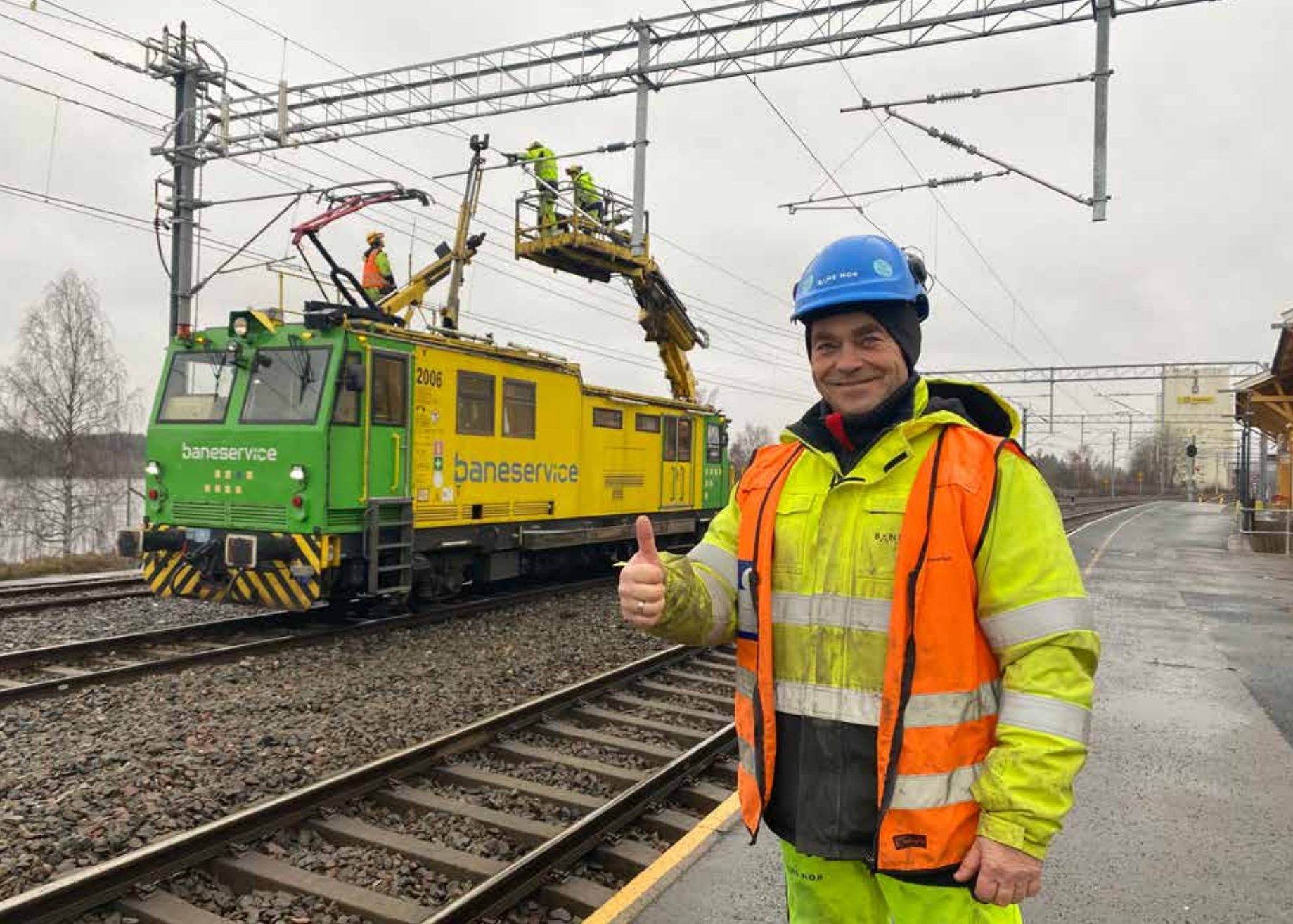
↑ NY TID: Byggeleder Odd Roar Tjosevik i BaneNOR gir tommel opp på Kongsvingerbanen etter at strømforsyningsanlegget fra Lillestrøm til Åbogen er oppgradert. Foto: Glenn Lund, BaneNOR.
