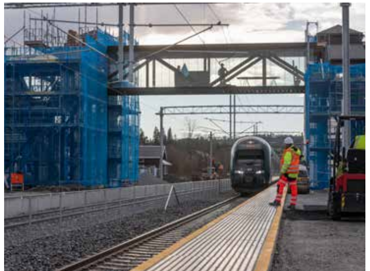
↑ REINSVOLL STASJON gjennomgår for tiden store endringer. Der bygges det både nytt kryssingsspor og overgangsbru med heiser. Kryssingssporet er nødvendig for å kunne kjøre timesavganger til og fra Gjøvik.
