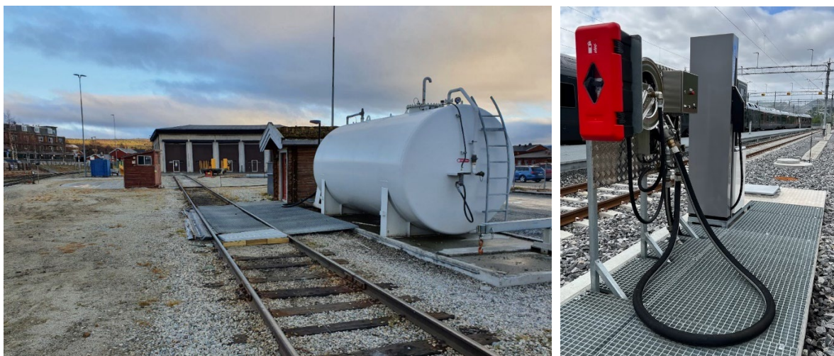
Figur 11: Fyllestasjon for diesel. Bildet til venstre er fra Røros hensettingsanlegg (svingskiven i bakgrunnen), mens bildet til høyre viser dispenser ved Støren påfyllingsanlegg (begge foto fra Network statement)
