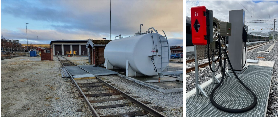
Figur 8: Fyllestasjon for diesel. Bildet til venstre er fra Røros hensettingsanlegg (svingskiven i bakgrunnen), mens bildet til høyre viser dispenser ved Støren påfyllingsanlegg (begge foto fra Network statement)
