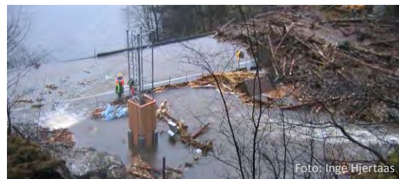
Figur 2.15 I 2005 ramma raset både veg og bane. Banen ligg under vatn i nedre del av biletet.
