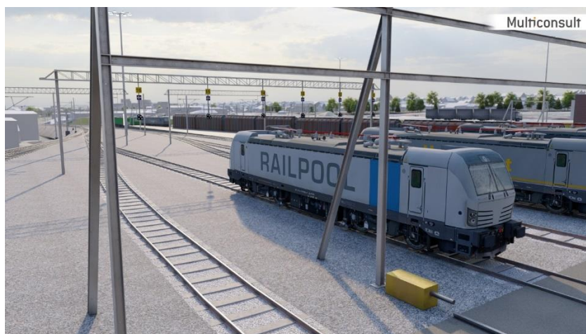
Figur 41. Dvergsignal og markerboards montert hengende fra åk.
