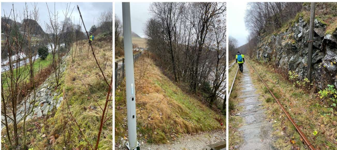
Figur 6-10: Til venstre erosjonssikring av fylling. I midten bratt skråning sør for Figgjo stasjon. Til høyre berg i dagen og løsmasseskråning (foto: Norconsult)
