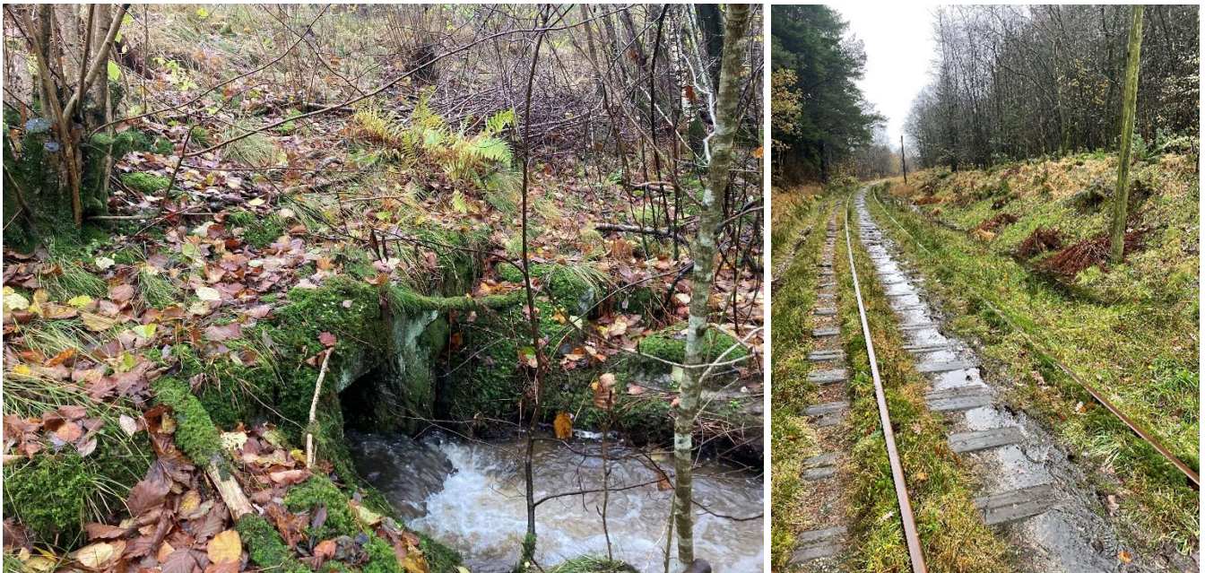
Figur 6-11: Til venstre et eksempel på en velfungerende tørrmurt stikkrenne, antakelig fra banens åpningsår. Til høyre et eksempel på gjengrodd grøfter og dårlig drenering (foto: Norconsult).
