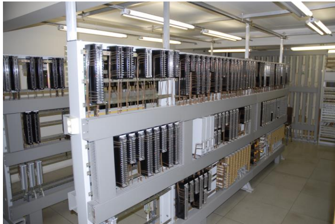
Figur 4-3 Koblingsrommet på et signalanlegg.
